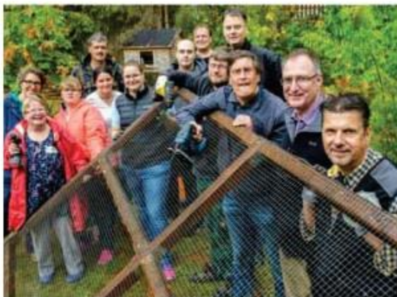
Gemeinsam packten Mitarbeiter der Sparkasse und Bewohner des Wohnheims beim Bau des Kaninchenstalls an.
